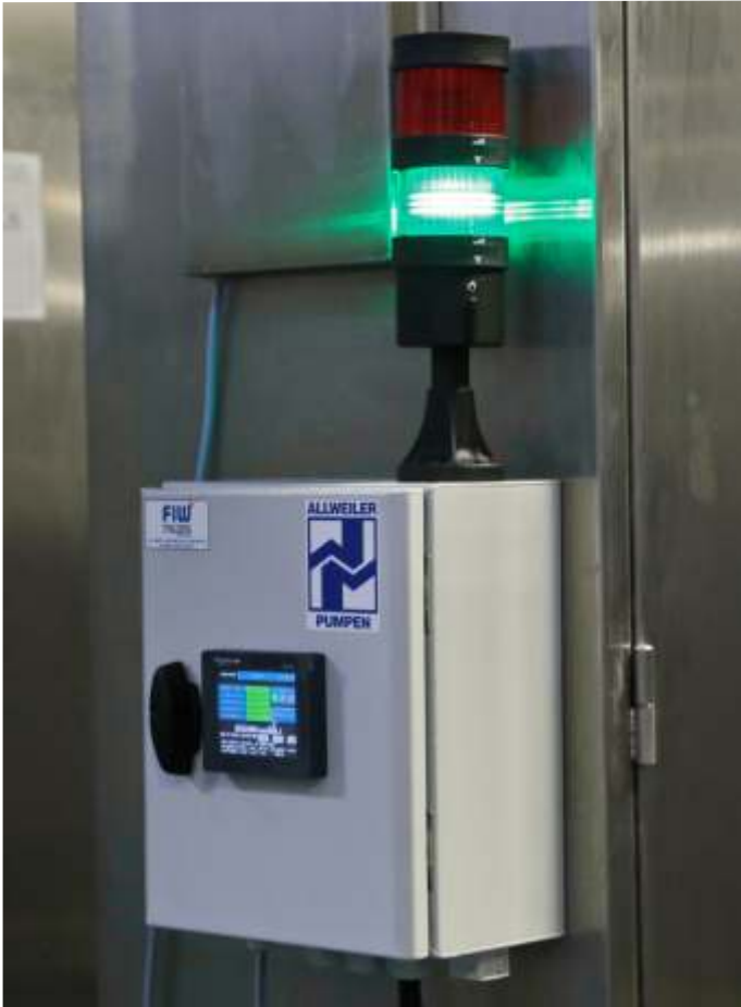
IN-1000 zeigt einen Normalbetrieb der überwachten Pumpen an.
