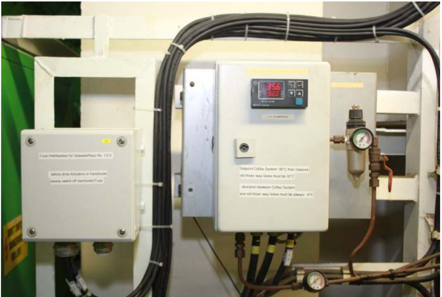
Verdrahtungsbox (links) für die Sensoren der CM-1000-Anlage. Kontrollbox (rechts) für den Reglerantrieb des Dreiwegeventils in der ursprünglichen Regelung der LT-Kühlwasseranlage. Auf der Kyoto Express liegt dessen Setpoint immer 4 °C unter dem Setpoint der CM-1000. Das stellt sicher, dass sich „alte“ und „neue“ Regelung nicht gegenseitig beeinflussen.
