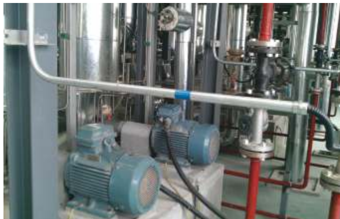
Pumpen der Baureihe CNH-B 32-250; Fördermedium T66 (Wärmeträgeröl)
