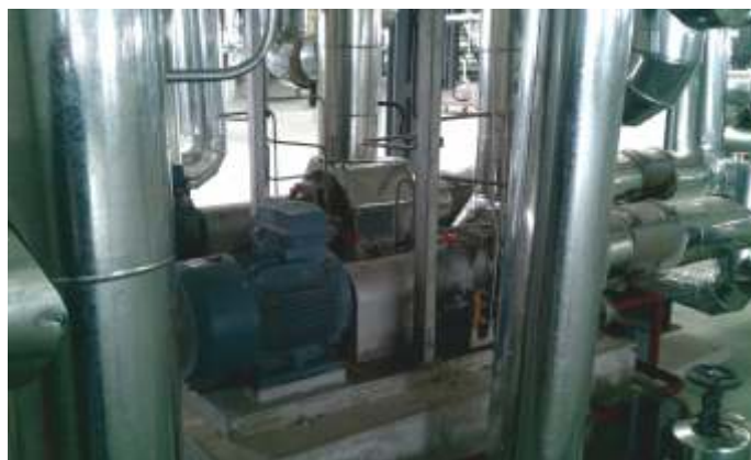
Pumpen der Baureihe CNH-B 100-200; Fördermedium T66 (Wärmeträgeröl)
