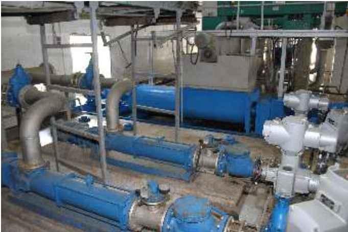
Anwendung: Schlammförderung Pumpenserie: Tecflow 2701 (at the front) Druck: 3 bar (43,5 psi) Fördermenge: 60 m 3 /h (264 gpm) Im Hintergrund: Hochdruckpumpe zur Schlammförderung
