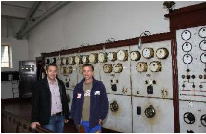
Ein Teil der früheren Schalttafel.
