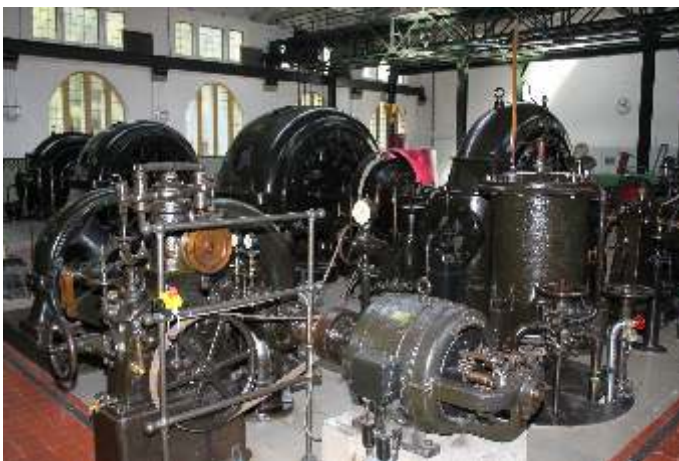
Einer der alten Maschinensätze, die von 1905 bis 1974 in Betrieb waren.
