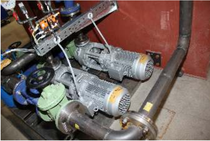
Zwei Kreiselpumpen des Fabrikats Allweiler® NBT im Kreislauf des Härteöls
