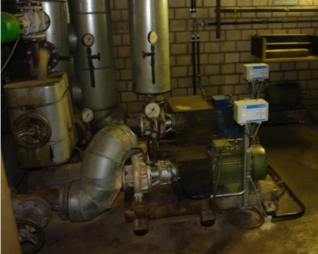
Thermalölaggregate mit ALLMIND-Installation
