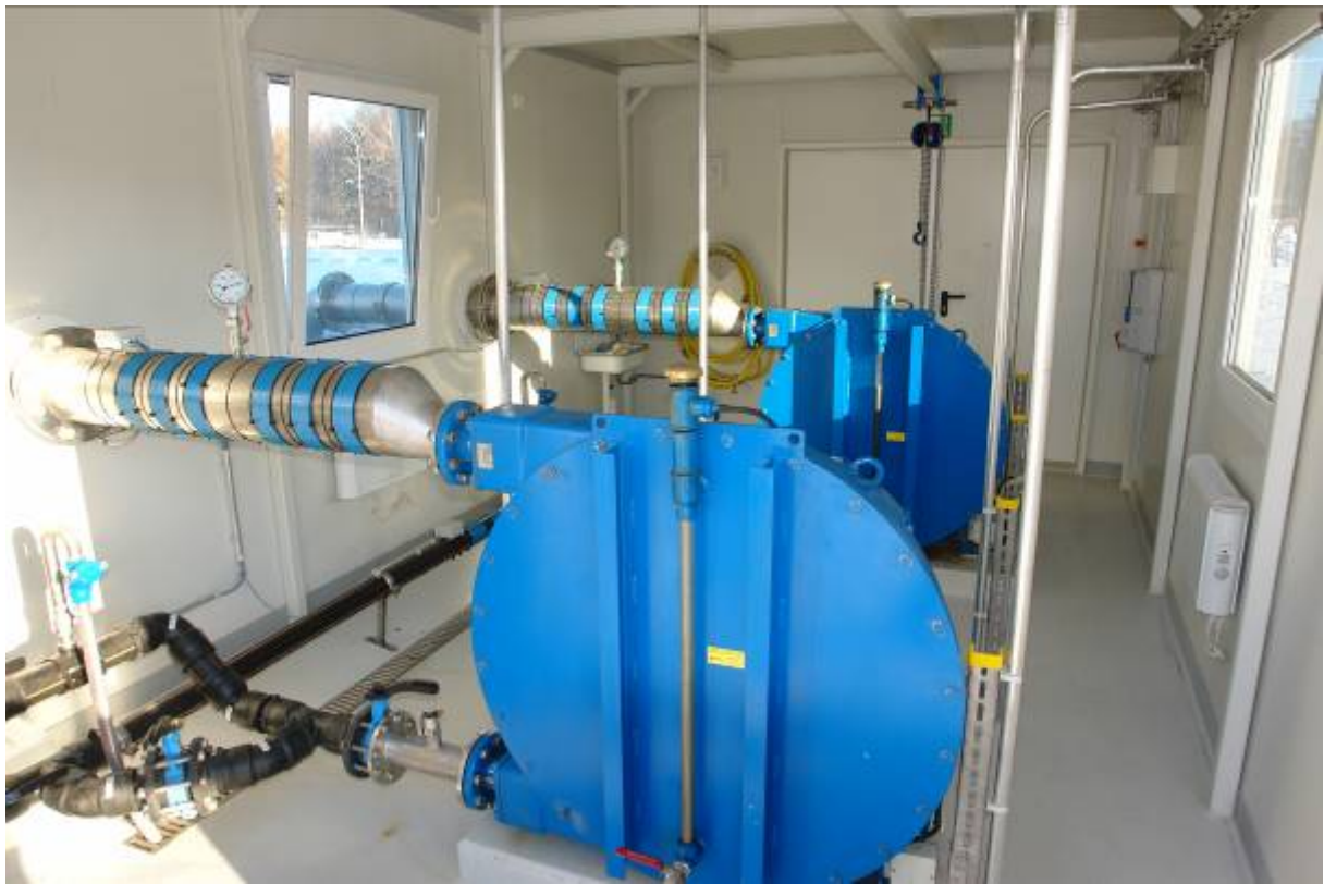
Die Schlauchpumpen sind redundant installiert.
