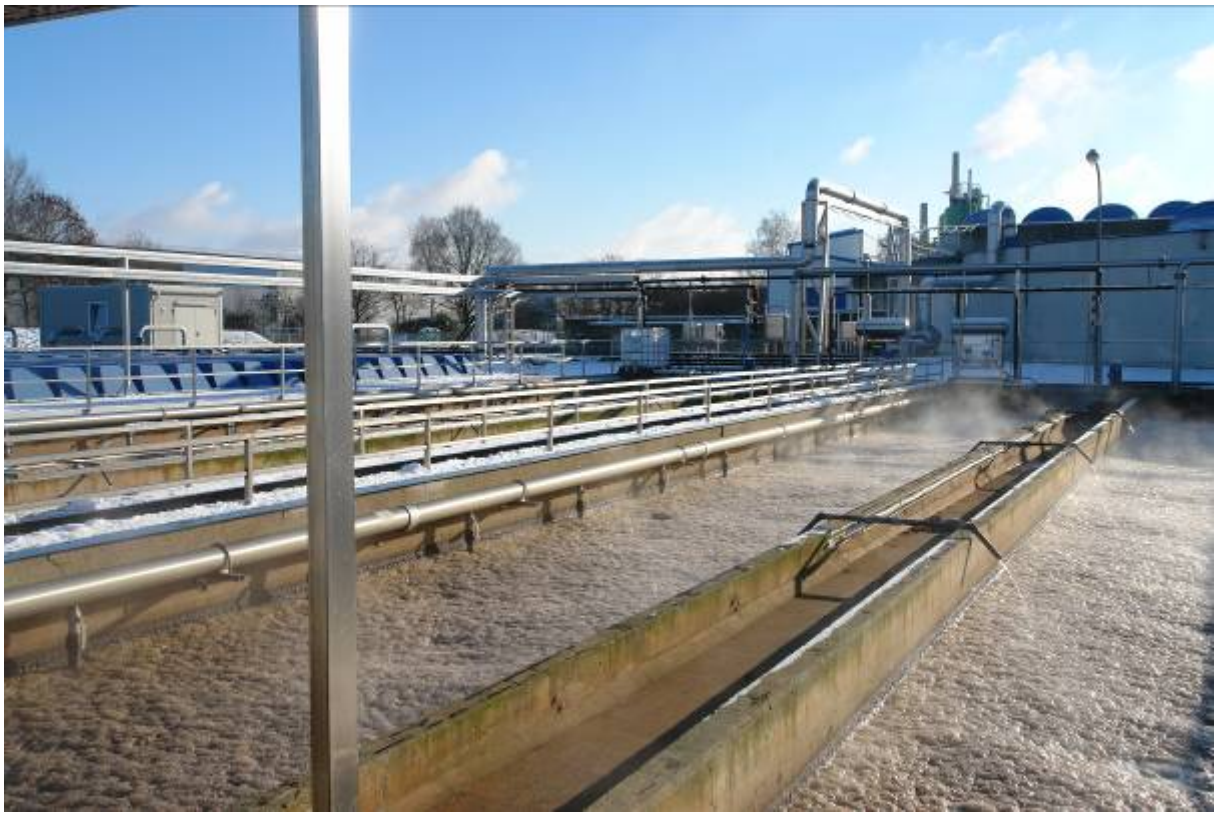
Bildunterschrift: SB-Reaktoren der Stickstoffeliminationsanlage
