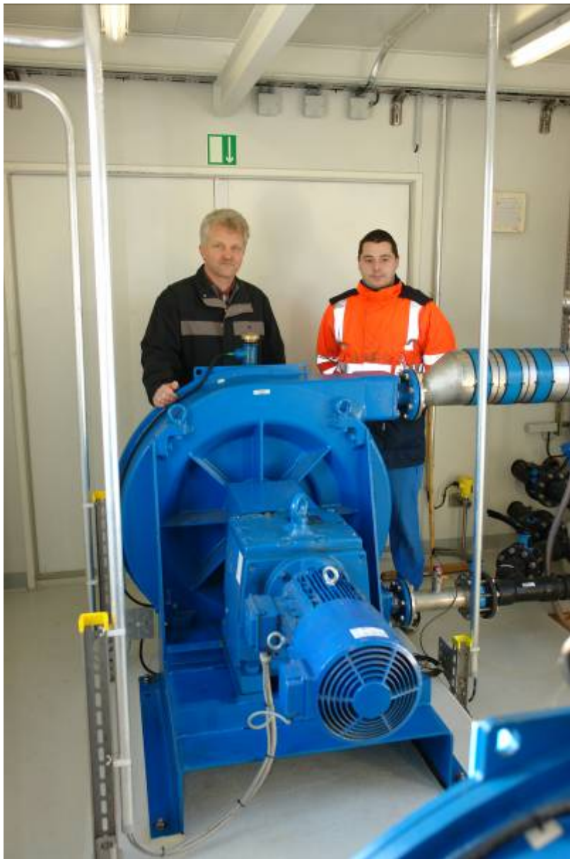
Allweiler Schlauchpumpe der Bauart ASH im Pumpenhaus der Stickstoffeliminationsanlage
