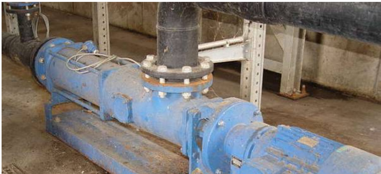
Allweiler Exzentrerschneckenpumpe der Baureihe AEB1E1450, Medium: Prozesswasser, Fördermenge: 60 m 3 /h, Druck: 2 bis 4 bar
