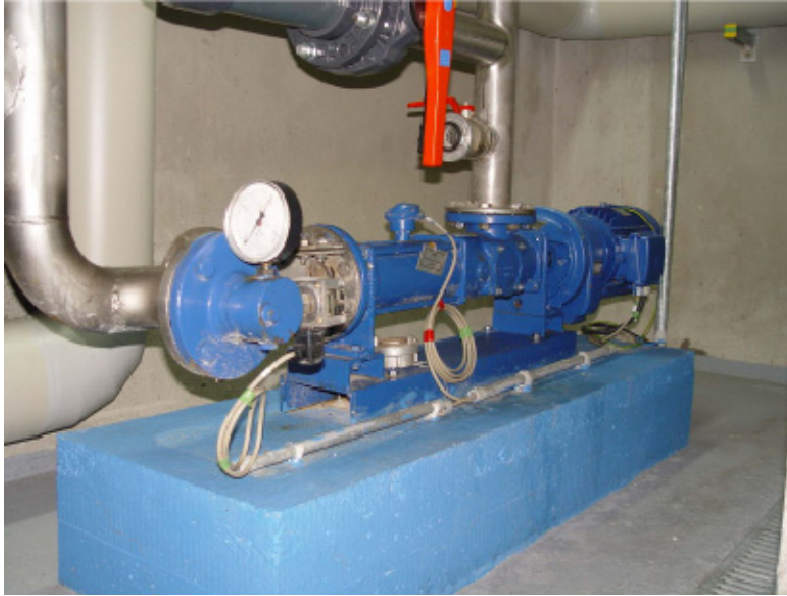
Beschickungspumpe der Allweiler-Baureihe SEDBP in Baugröße 300. Förderung von Fett zum Faulturm (85 l/min).
