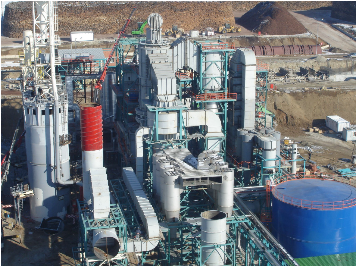
Bildunterschrift: 48 MW biomassegefeuerter Heißgaserzeuger mit 8 Thermalölumwälzpumpen und 1 Kühlwasselumwälzpumpe
