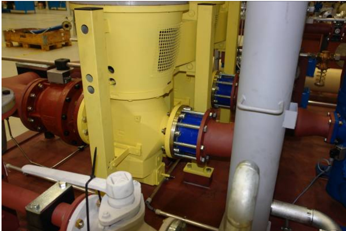
Dreispiendelige Schraubenspindelpumpe der Baureihe TRF in einer Ölversorgungsanlage (Bauart „OWGM“) für einen Vertikalmühlenantrieb. Gefördert wird Synthetik- oder Mineralöl VG320 mit einem Druck von 10 bar.
