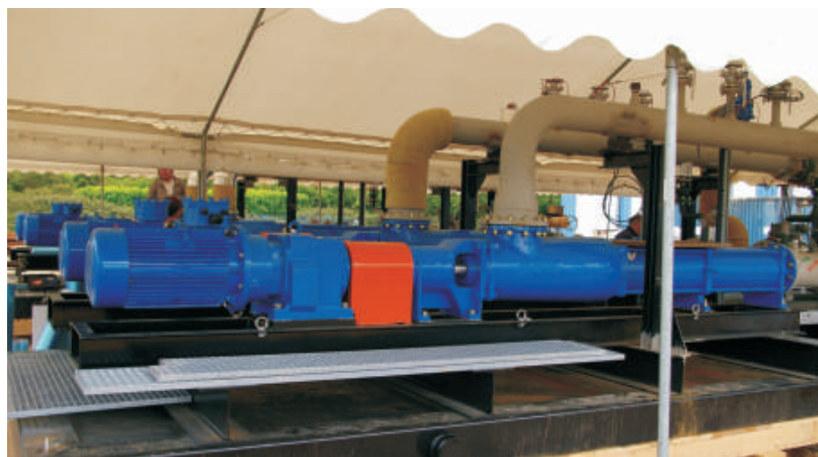
ALLWEILER Exzentrerschneckenpumpen sind als Entwässerungs- und Wärmetauscherpumpen eingesetzt.
