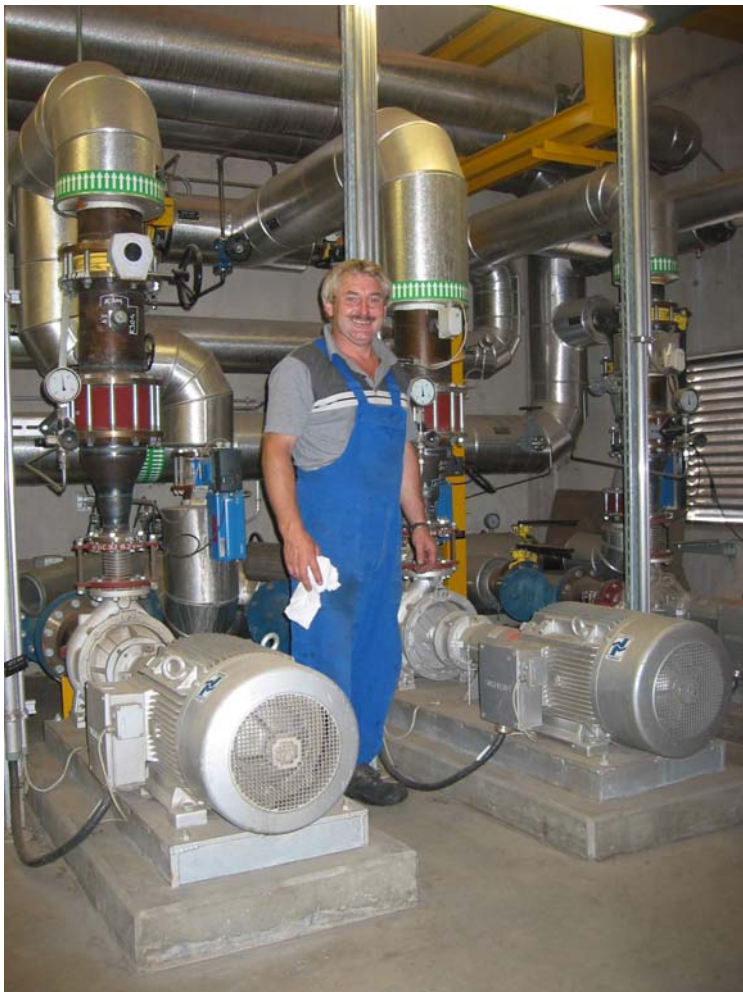
Richard Geider, Betriebs- leiter Biomassekraftwerk Güssing ist mit seinen innovativen Allweiler ALLHEAT Pumpen sehr zufrieden.
