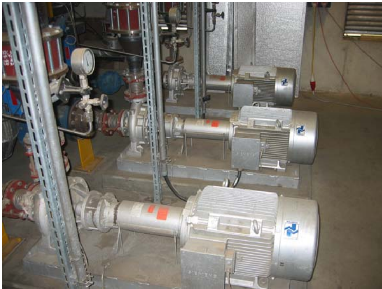
Allweiler ALLHEAT Kreiselpumpen im Biomasse-Kraftwerk Güssing.
